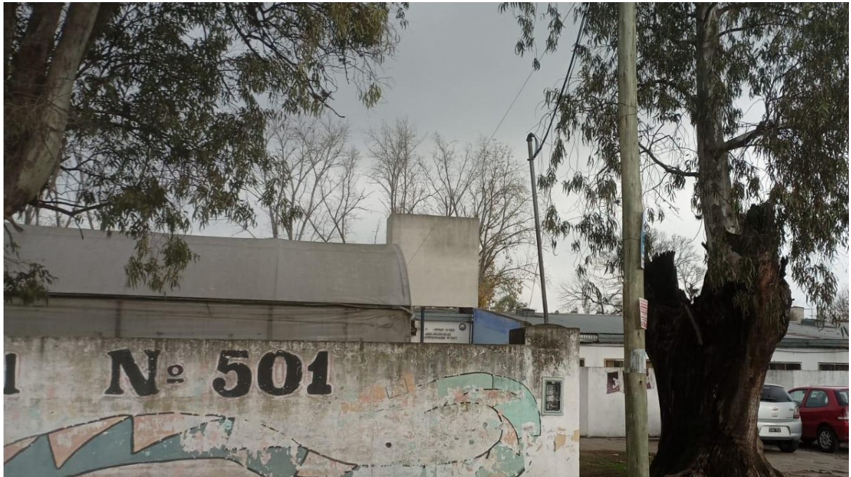
Se observa medidor eléctrico existente.
